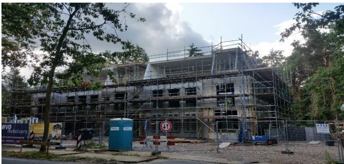
Nieuwbouw appartementencomplex aan de Valckenboschlaan; een voorbeeld van ongewenste inbreiding en ontgroening van de wijk.
